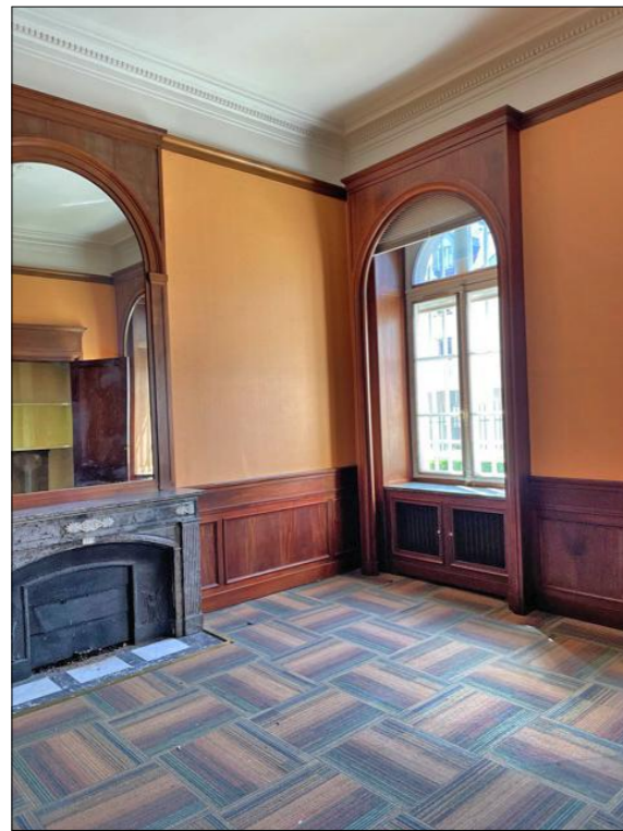
Photo 3 - pièce à conserver
